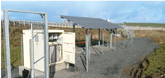
Stromversorgung einer Mess-Station zur Geschwindigkeitskontrolle
