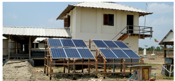
Stromversorgung einer Krankenstation
