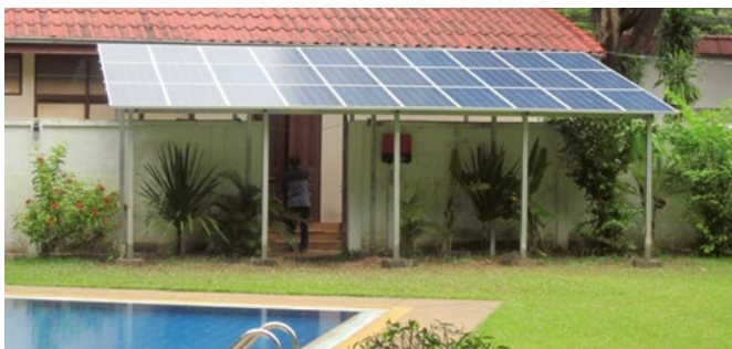
Stromversorgung bei Netzausfall
